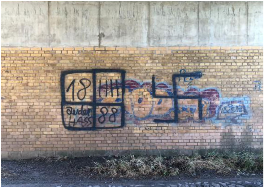
Abbildung 6: Antisemitische Schmierereien an einer Bahnbrücke bei Calbe (Saale)
